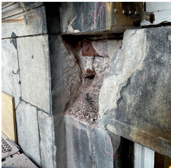
Zware schade aan de zandsteenblokken door roestende ankers. Een groot deel van het blok is afgebroken en tijdens de restauratie verwijderd. Achter de natuursteen zijn de in 1670 hergebruikte kloostermoppen zichtbaar. Midden in het gat een afgebroken roestend anker, boven in het gat twee schuinlopende roestende ankers (Erfgoed 's-Hertogenbosch, foto Ronald Glaudemans).
