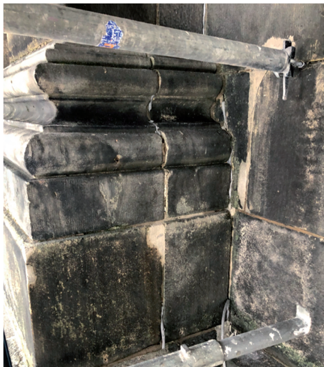
Detail van een basement in de gevel, voorafgaand aan de restauratie, met openstaande voegen, willekeurig dichtgesmeerde gaten en ernstige vervuiling van de steen (Erfgoed 's-Hertogenbosch, foto Ronald Glaudemans).
