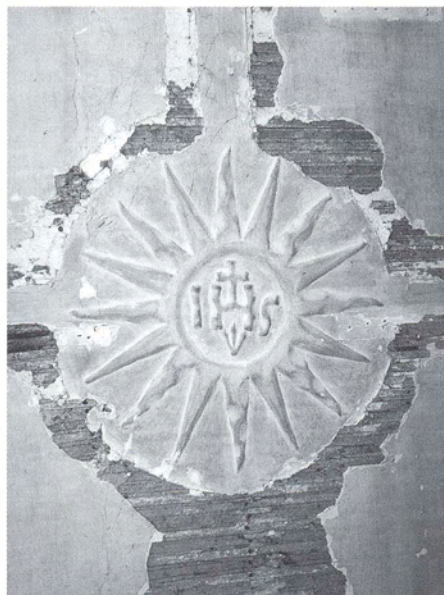
Het IHS-monogram, het omringende lijstwerk is verdwenen. Ter plaatse van de ontbrekende delen zijn de rinkellatten als drager van het plafond zichtbaar. De latten zijn met gesmede spijkers tegen de kinderbalken bevestigd. (Foto: BAM)
